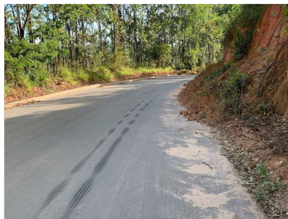
Fig.5 Material atingindo pista de rolamento
