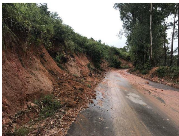
Fig.4 Deslizamento de Taludes
