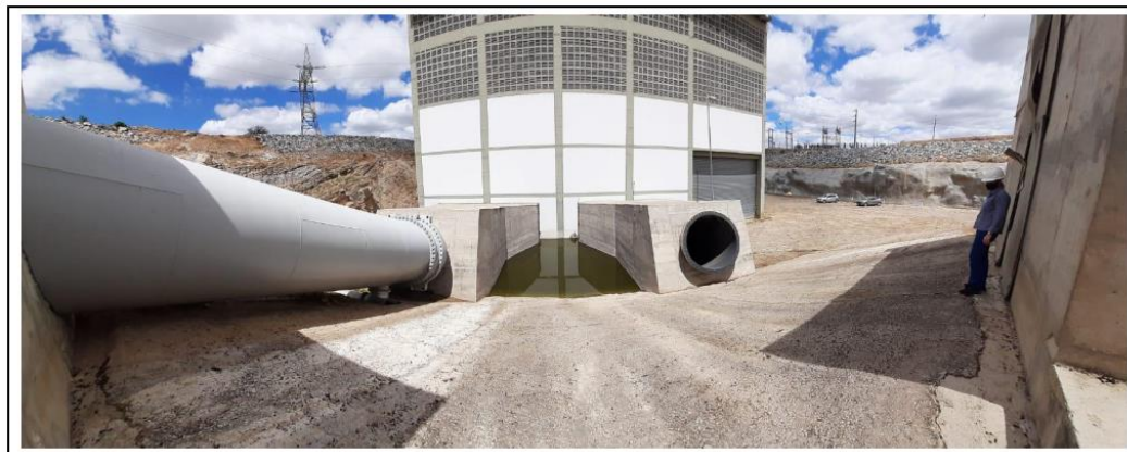
Foto 2 - Local da retirada da válvula com inclinação
