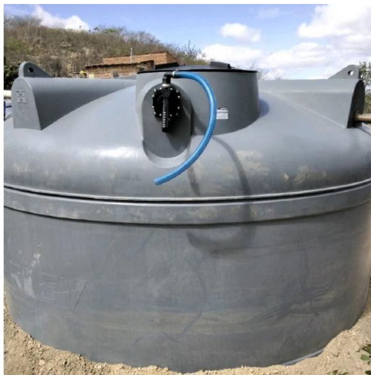
Figura 5: Exemplo de reservatório de 16.000L instalado.
